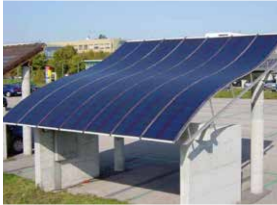
Figure 2-5 Module PV à couche mince
